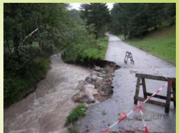
Auch unsere Straßen wurden - wie hier in der Steinapiesting - teilweise schwer in Mitleidenschaft gezogen.
